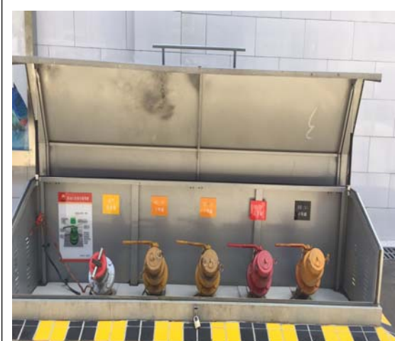
卸油油气回收
