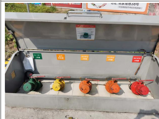
卸油口及一次油气回收系统
