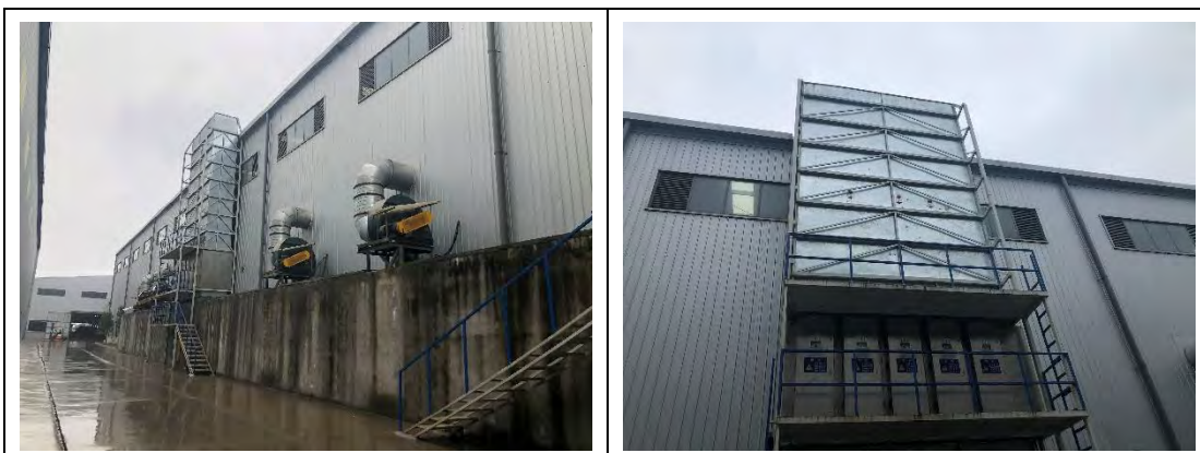
2套“过滤棉+UV 光氧+活性炭吸附装置+15m 排气筒”氟碳漆废气处理系统
