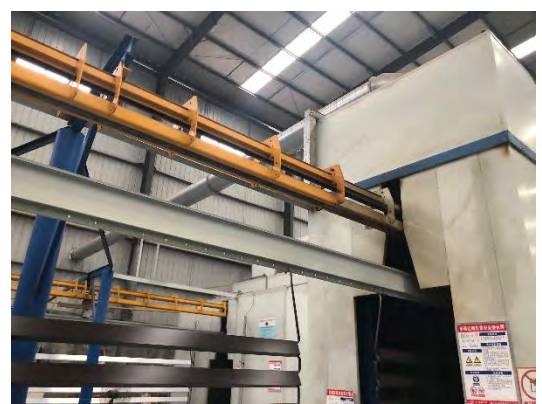
氟碳漆固化天然气及燃烧废气收集管道
