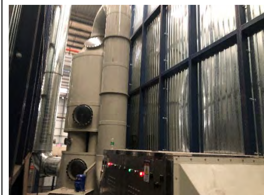
立式固化废气喷淋塔
