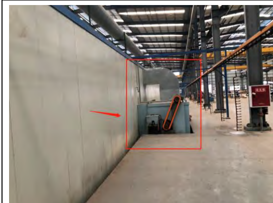
氟碳漆固化有机废气燃烧室
